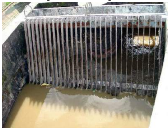
Figura 19. Sistema de gradeamento.
