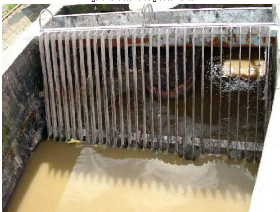
Figura 19. sistema de gradeamento.
