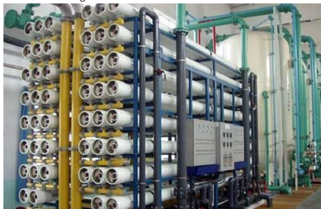
Figura 29. Sistema de osmose reversa.
