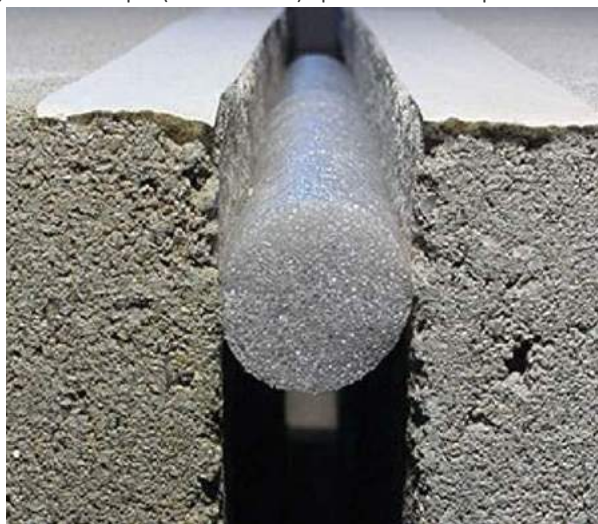
Figura 6. Mástique (cilindro cinza) aplicado como impermeabilizante.
