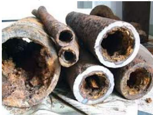
Figura 8. Tubulação com incrustação proveniente da água dura.
